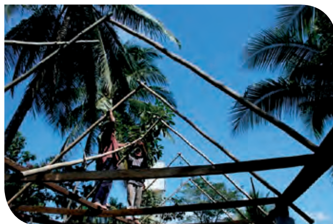
Figura 9. Colocación y nivelación de los ‘pies de tijera’ amarrados a los travesaños.
