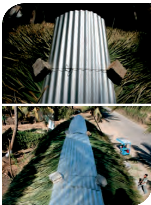
Figura 20. Plancha de lámina zinc sujeta con piedras en la parte superior de la palapa.
